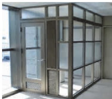
<会館3階喫煙ルーム>
